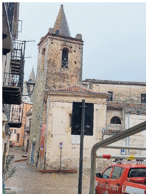
Isnello. La chiesa danneggiata: è crollata la croce
