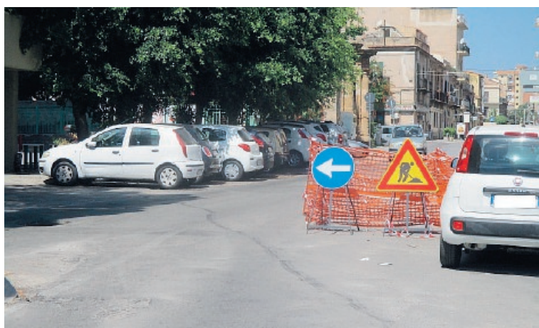
Via Resuttana. Chiesti interventi per sistemare una voragine sull'asfalto
