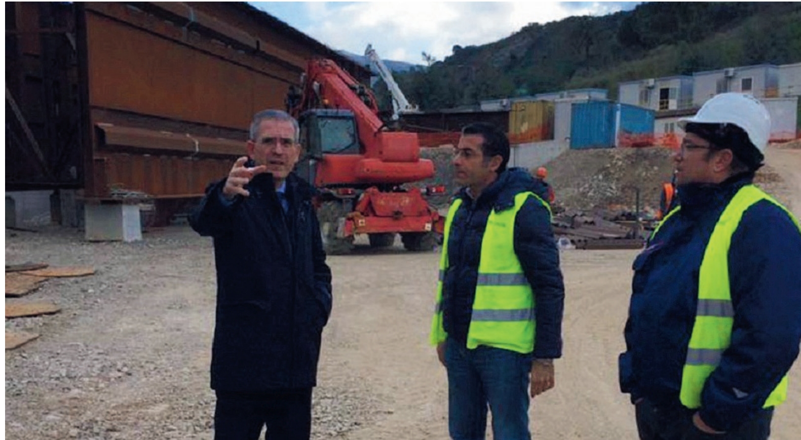
Cantieri-lumaca. Un sopralluogo dell'assessore regionale Marco Falcone durante i lavori per il viadotto Imera
